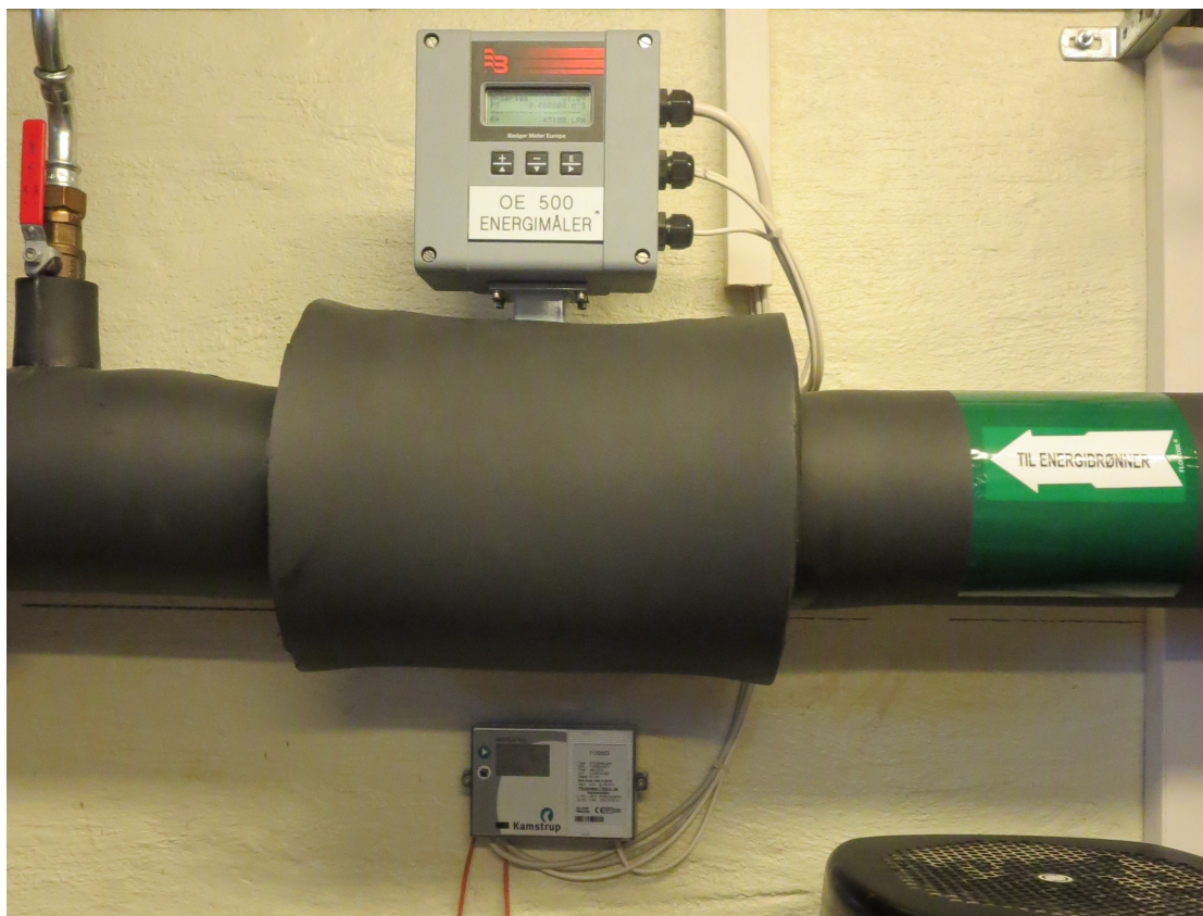
Figur 21: Bilde av mengdemåleren OE500 på Ljan skole.
