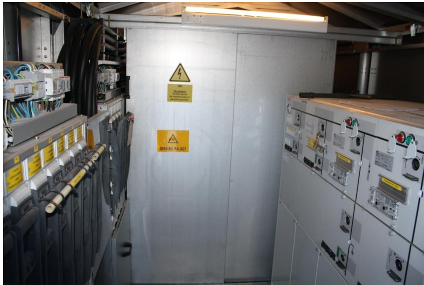
Figur 6.11 Innvendig rom i betjent nettstasjon (19)
