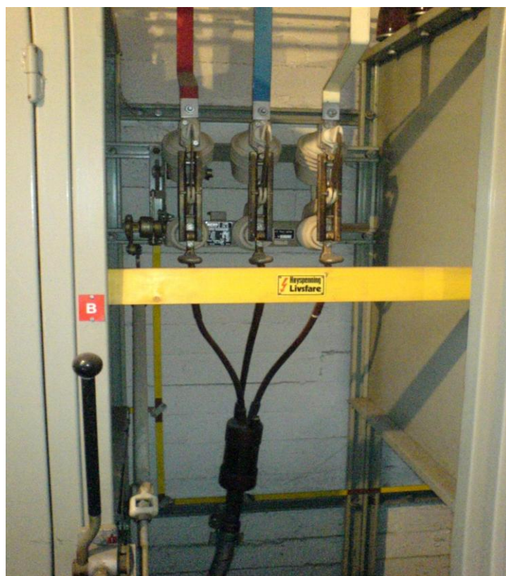
Figur 6.2 Høyspentarrangement i en eldre MV/LV nettstasjon
