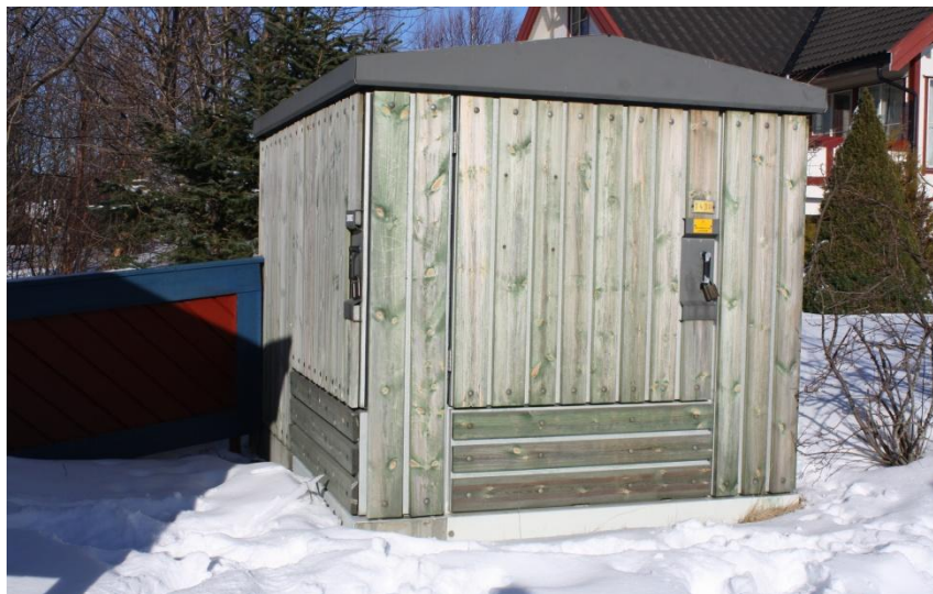
Figur 6.7 Utvendig betjent nettstasjon (19)
