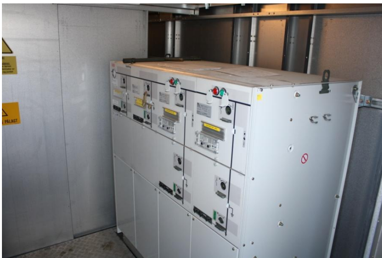
Figur 6.3 SF 6 -isolert høyspentanlegg i en nyere MV/LV nettstasjon (19)
