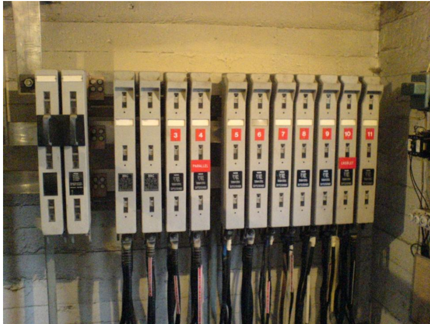
Figur 6.5 Lavspennetavle i MV/LV nettstasjon
