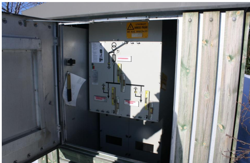
Figur 6.8 Høyspentdel i utvendig betjent nettstasjon (19)
