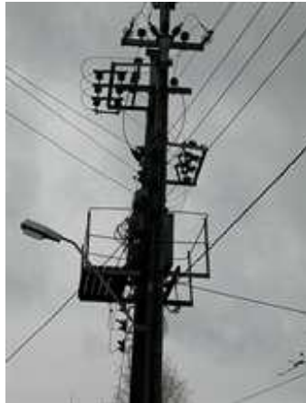
Figur 6.6 Nettstasjon lokalisert i mast (23)
