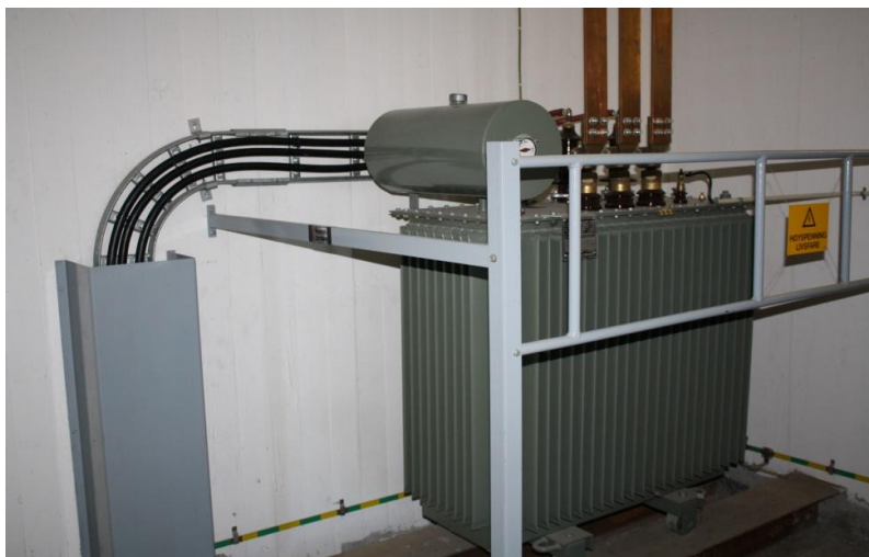
Figur 6.4 Fordelingstransformator i en MV/LV nettstasjon (19)
