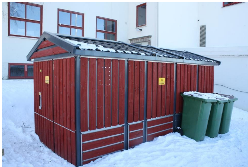
Figur 6.10 Innvendig betjent nettstasjon (19)
