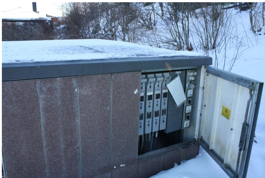
Figur 6.9 Lavspennetavle i utvendig betjent nettstasjon (19)
