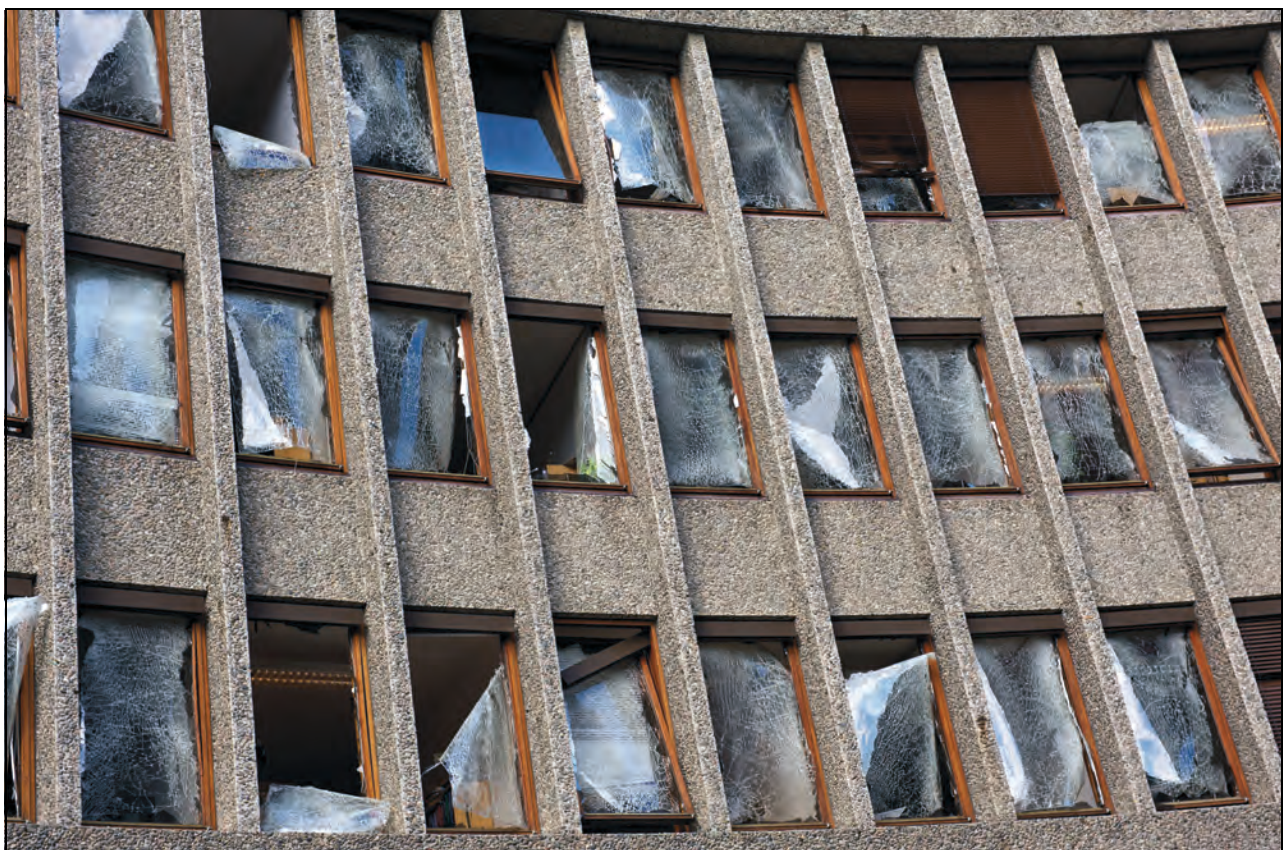
Figur 18.10 Folierte vinduer i regjeringkvartalet begrenset skadene.
