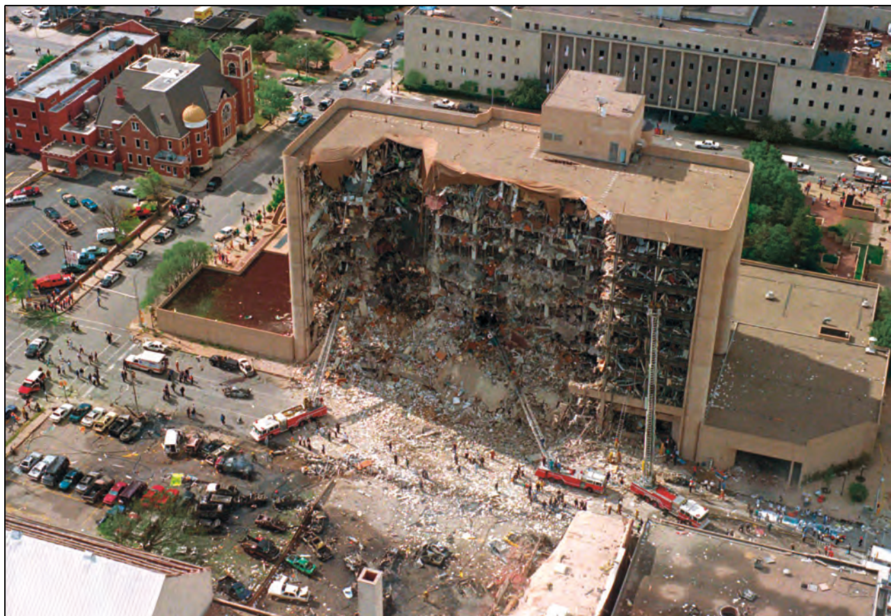
Figur 4.3 Massive ødeleggelser som følge av angrepet mot USAs føderale myndigheters administrasjonsbygning i Oklahoma City 1995.
