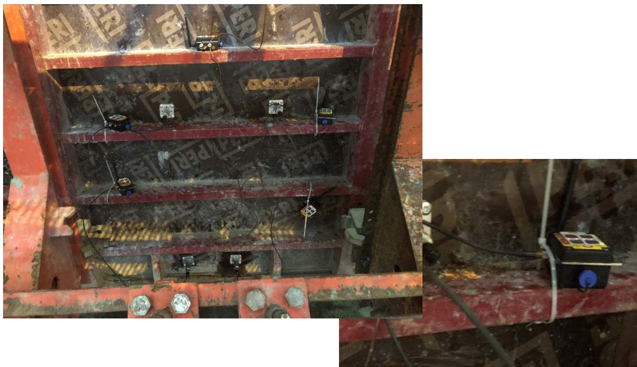
Figur 12: For å kunne styre produksjonen bedre, ble det i Sitecast gjort et forsøk med utprøving av støpetrykksensorer på forskalingen. Forsøket ble utført i Veidekkes prosjekt «R26», sammen med Peri. Foto: Yngve Urnes, PERI
